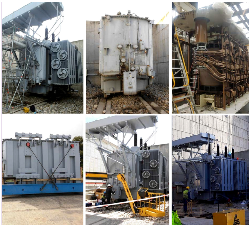
Figura 3. Fases en el proceso de recalificación de un transformador auxiliar de arranque.
