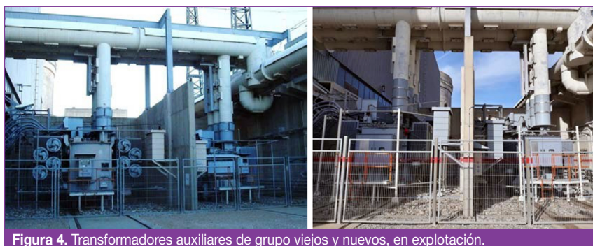
Figura 4. Transformadores auxiliares de grupo viejos y nuevos, en explotación.
