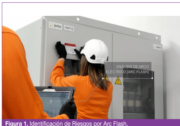
Figura 1. Identificación de Riesgos por Arc Flash.
