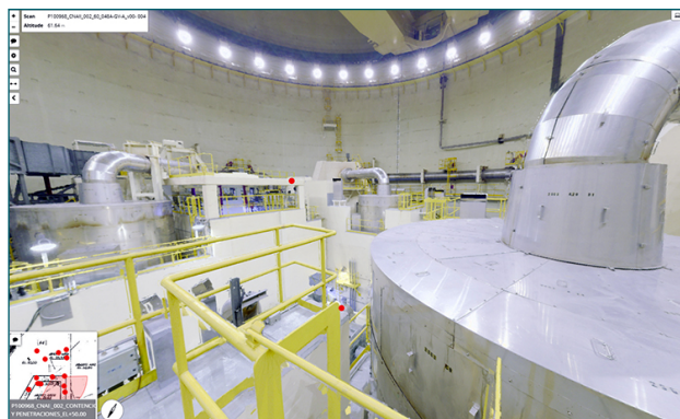
Figura 3. Vista de la contención con los tres generadores de vapor de C. N. Ascó.
