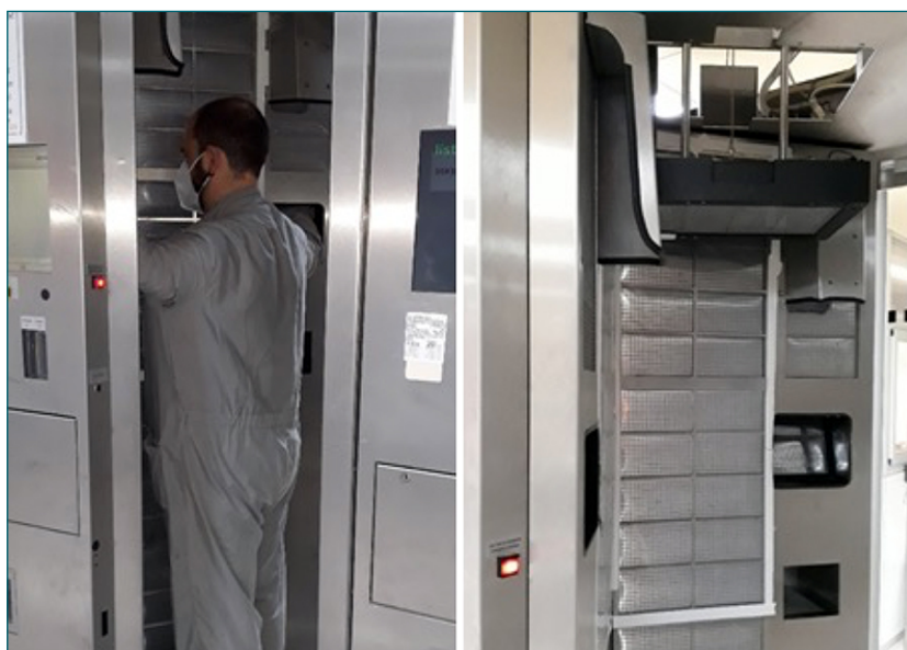
Figura 2. Pórticos beta en la salida de zona controlada de C.N. Vandellòs II.
