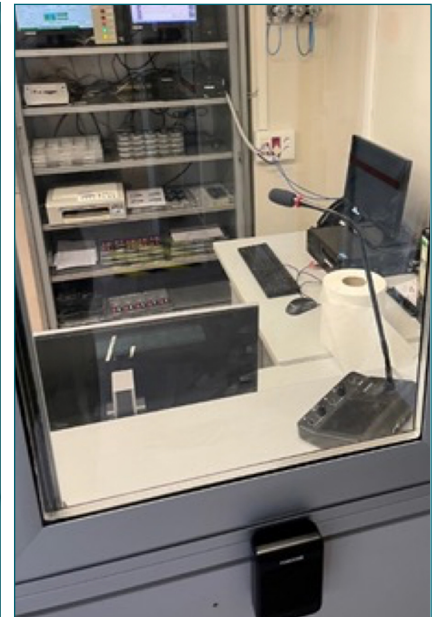
Figura 4. Dispositivos de comunicación a distancia instalados en la ventanilla de PR.
