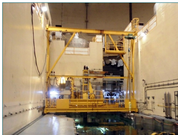
Figura 5. Vista general de la manipuladora de combustible de contención.
