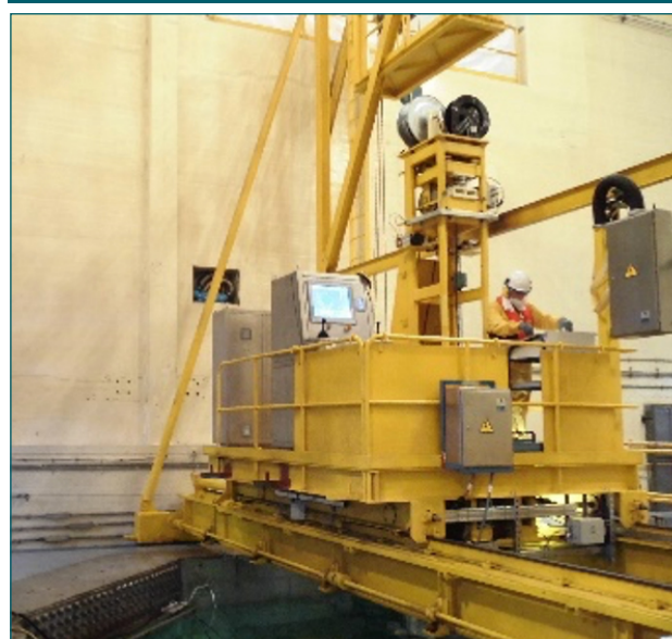
Figura 6. Carro y equipos de la manipuladora de contención.
