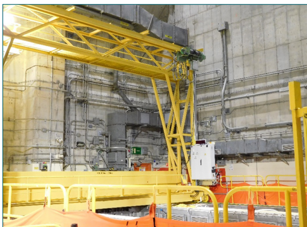
Figura 7. Vista general de la manipuladora de la piscina de combustible gastado renovada.
