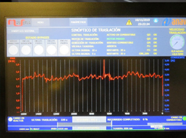
Figura 8. Nuevo control del sistema de transferencia de combustible implantado en C.N. Vandellós II.
