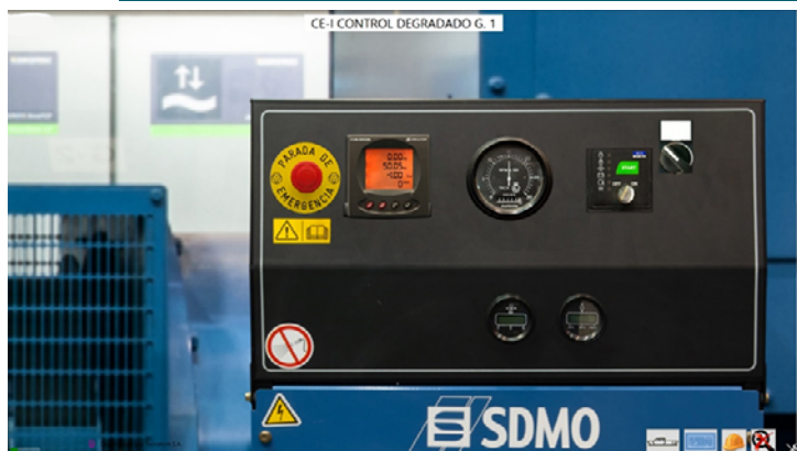
Figura 8. Panel de control grupo diésel.
