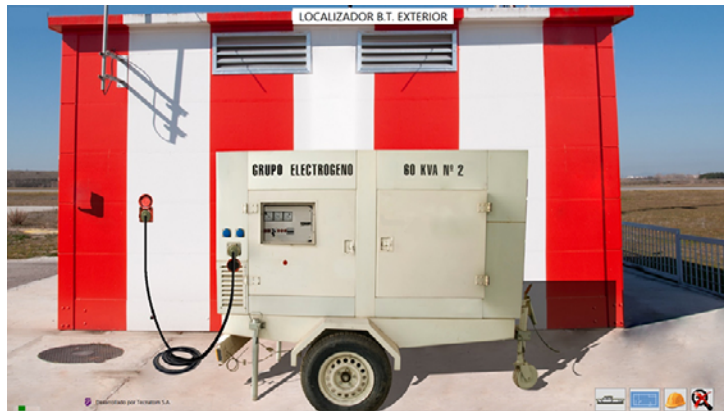
Figura 9. Generador diésel portátil.
