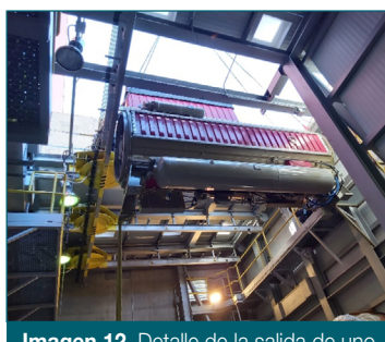
Imagen 12. Detalle de la salida de uno de los polos.
