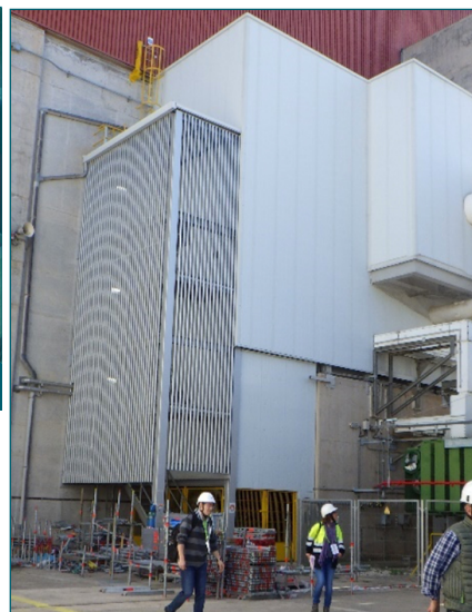
Imagen 3. Vista Edificio Interruptor.
