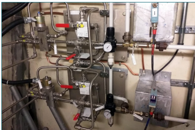
Figura 5. Detalle de placas neumáticas.
