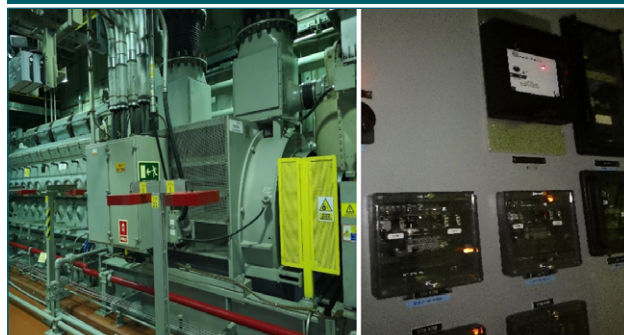
Figura 5. Generador Diesel divisional y nuevas protecciones electromecánicas instaladas en 2021.
