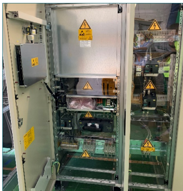
Figura 4. Nuevo cargador de batería divisional instalado en 2021.
