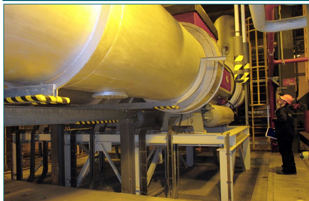
Imagen 2. Barras de fase aislada e interruptor de generación de C.N. Trillo.
