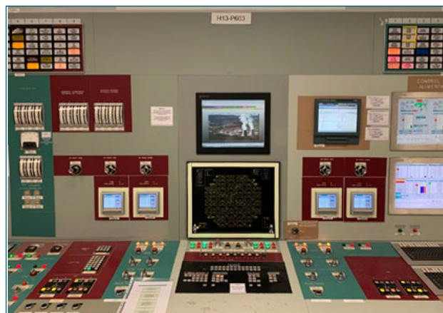
Figura 2. Consola de control de C.N. Cofrentes.
