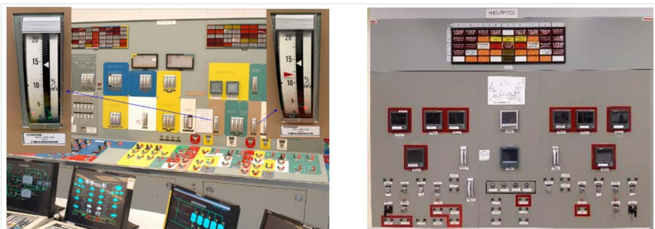
Figura 4. Interfaz persona-máquina en paneles de Sala de Control.
