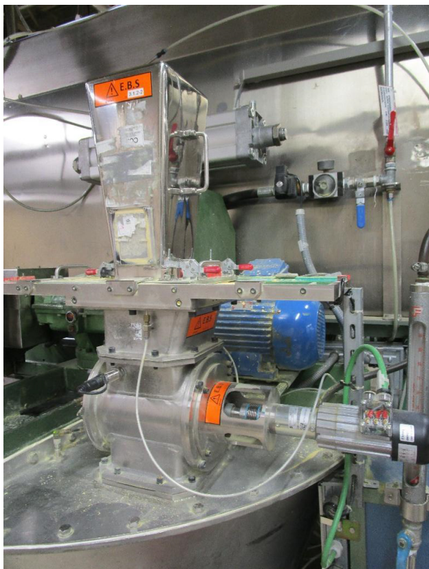
Figura 7. Sistema de dosificación de aditivos moderadores etiquetado como EBS.
