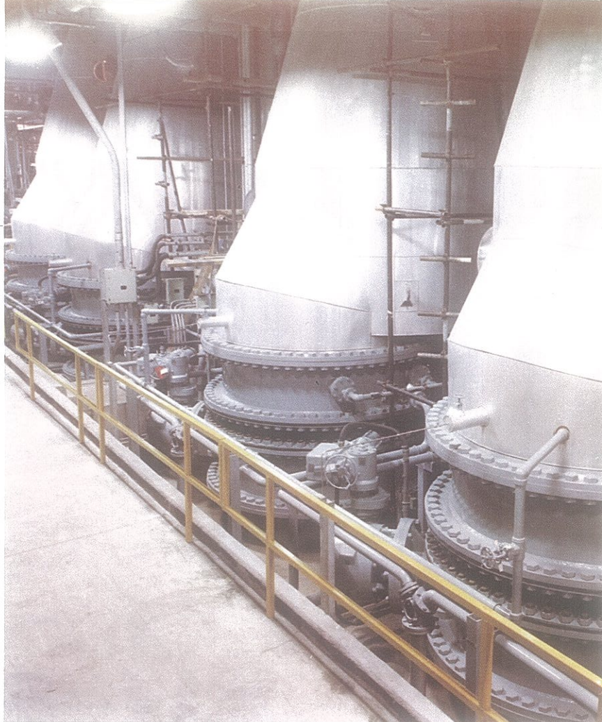
Cajas de agua de los acumuladores (CN Almaraz).
