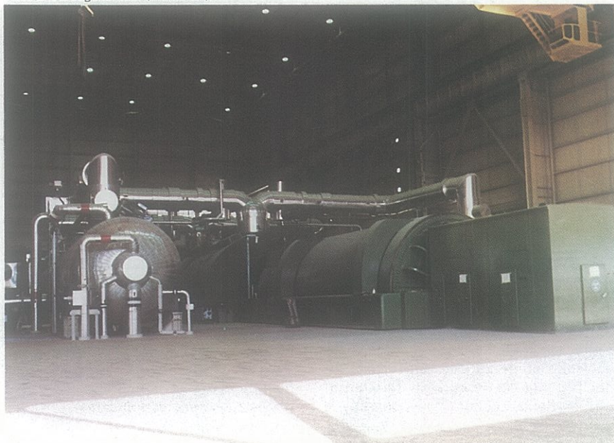
Ascó I. Turbogenerador (marzo 82).
