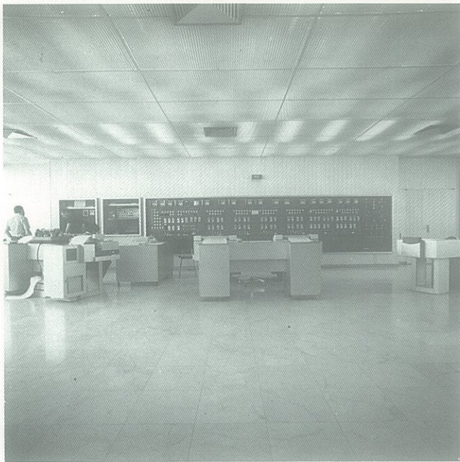
8. Sala de control.
