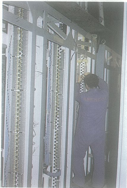
C. N. Cofrentes. Conexión de paneles de relés en la sala de control.
