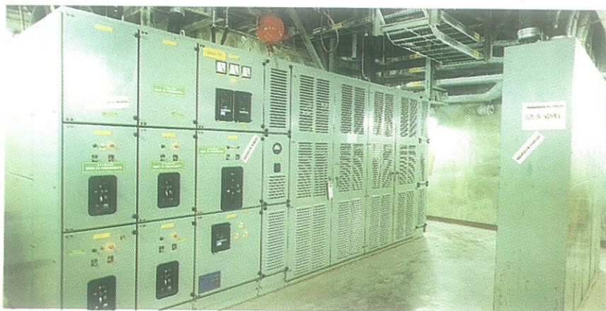
Centro de transformación
