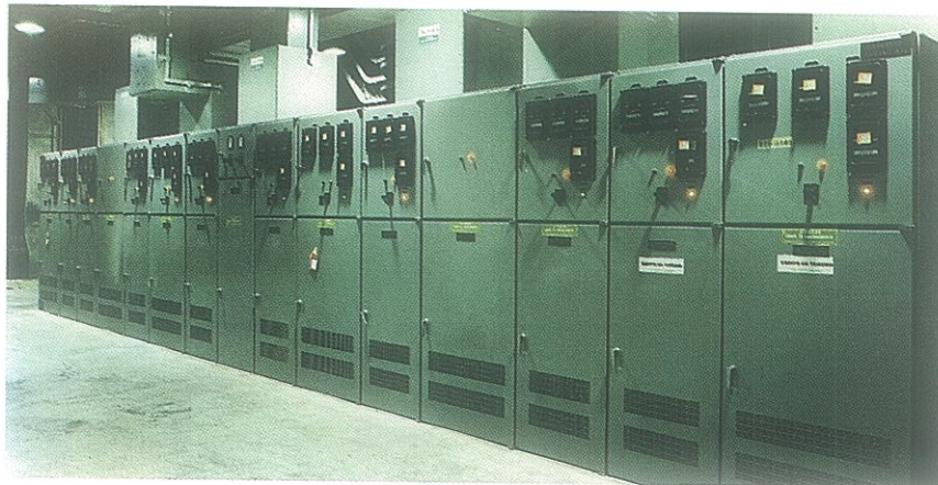
Cabinas de 6,5 KV y barras agrupadas
