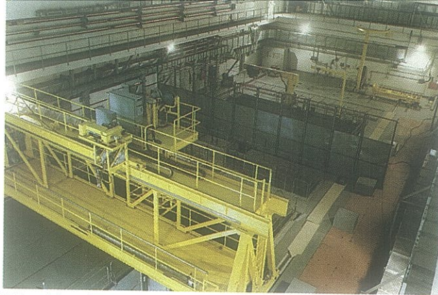
Edificio del combustible. Planta de operación. Vista de las piscinas de almacenamiento, plataforma de manejo del combustible, grúa y valla de protección zona restringida
