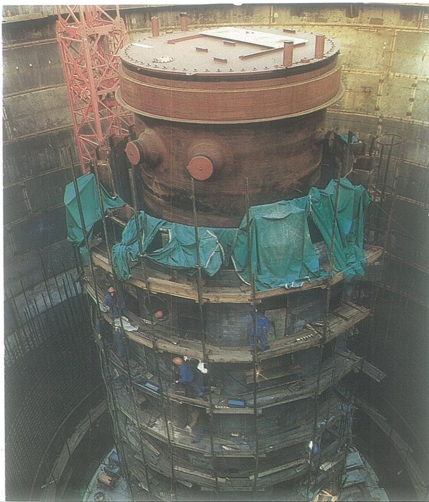
Edificio del reactor. La vasija y su blindaje
