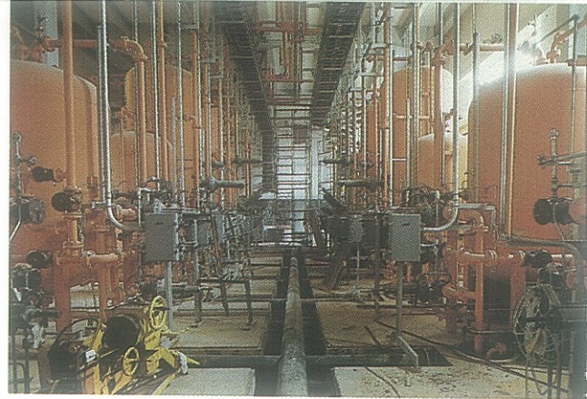
Edificio de tratamiento de agua. Pasillo entre las dos cadenas de depósitos de resinas intercambiadores de ión.
