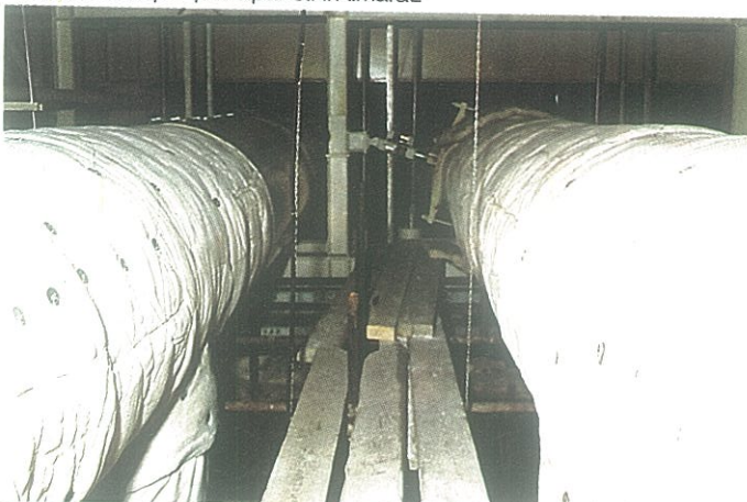
Tuberías con inspección en servicio C.N. Ascó
