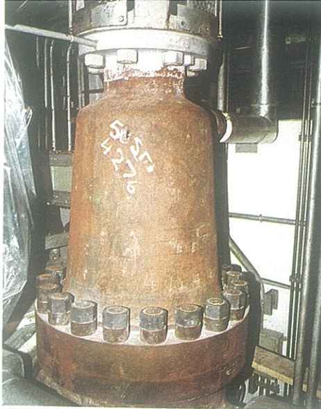
Válvulas de vapor principal C.N. Almaraz
