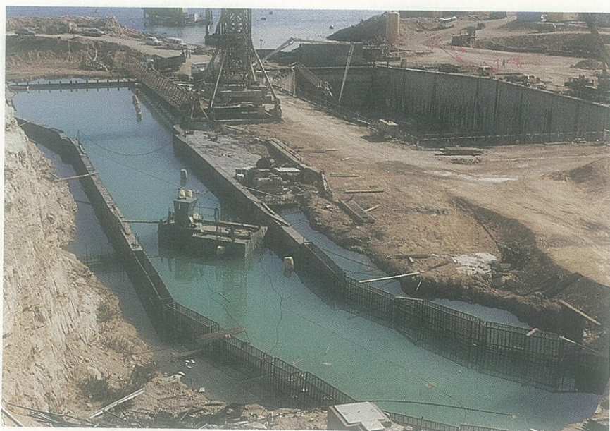
Canal de agua
