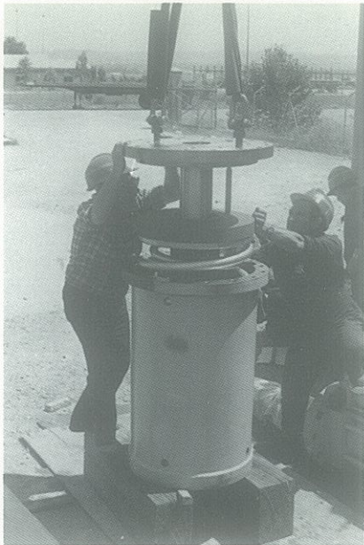
Actuador de una válvula de control de la central. Operaciones de mantenimiento.
