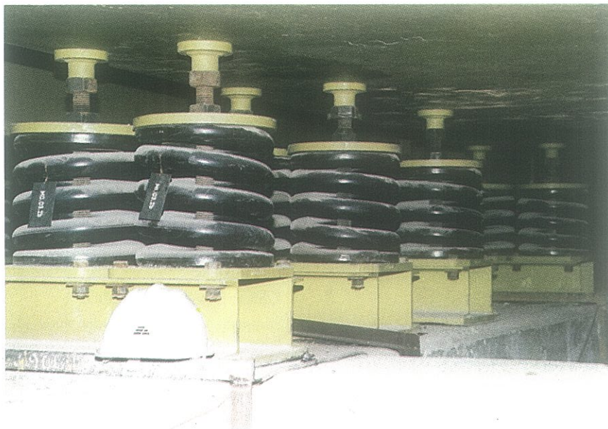
Edificio turbina. Detalle de los muelles de soporte del condensador.
