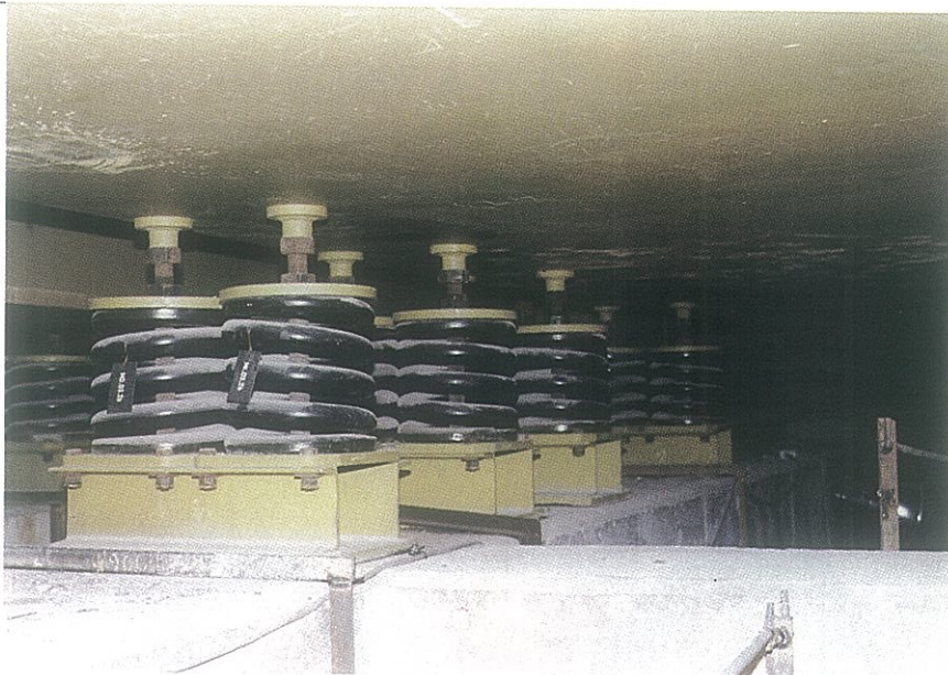
Detalle de muelles de soportado del turbo-generator.
