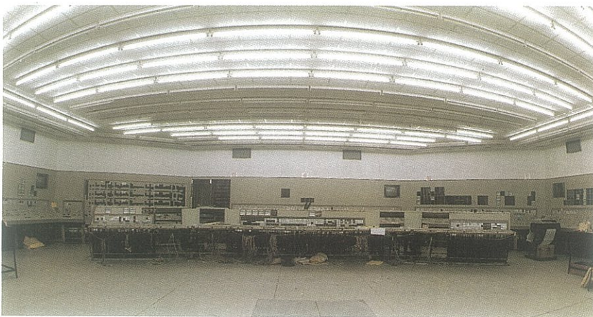
Vista general de los paneles en la sala de control en fase de cableado.
