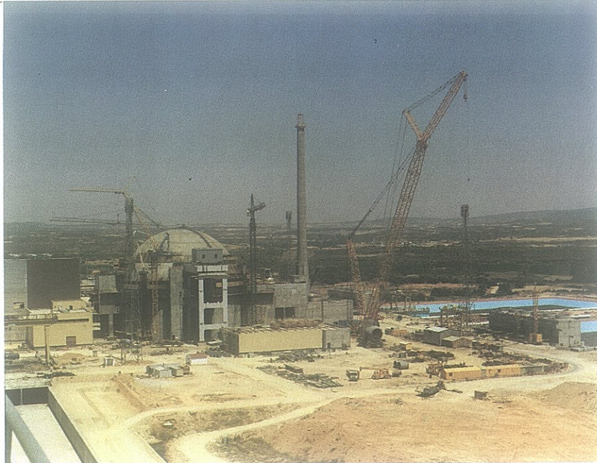
Vista general grúa Demag 2100 y grúa pórtico para acceso al reactor.
