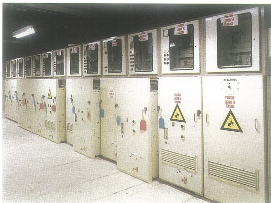
Cabinas de 10 KV.
