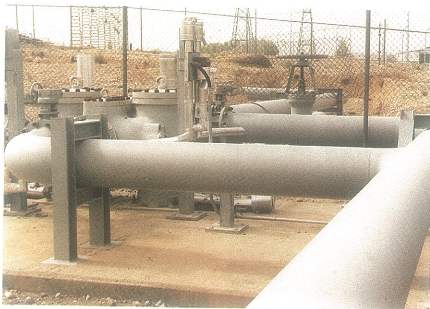
Sistema de agua de servicios esenciales.
