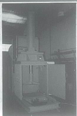
Compactadora CN VANDELLOS II CN TRILLO
