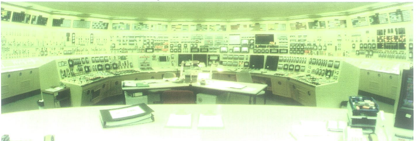
Vista general de la sala de control.
