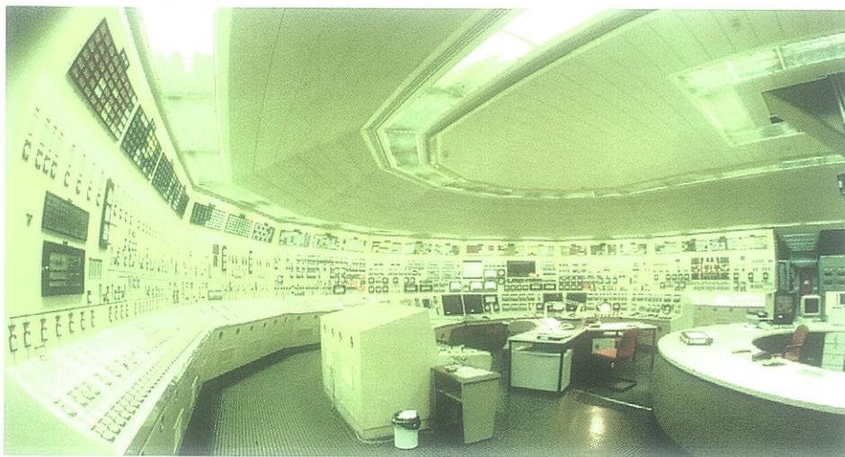
Detalle de sala de control.
