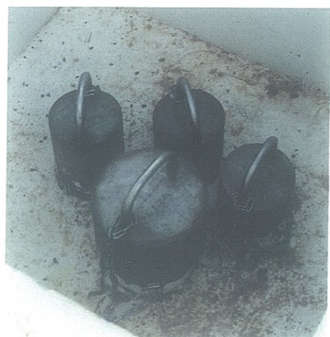
F VIII Aspecto final de los tubos piezómetros y de muestreo.
