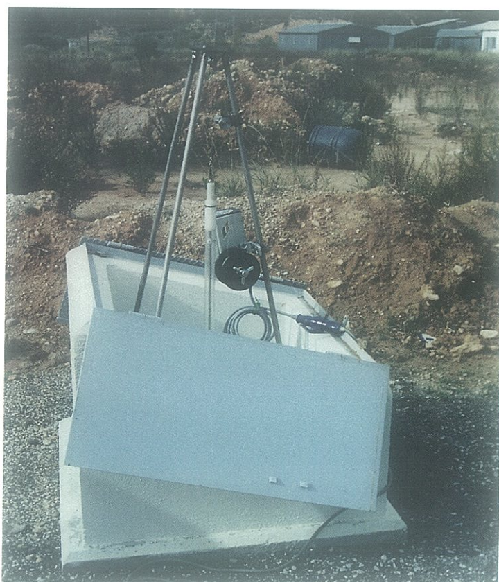
FIG Elementos utilizados para la medición de los niveles y toma de muestras en los tubos piezométricos.
