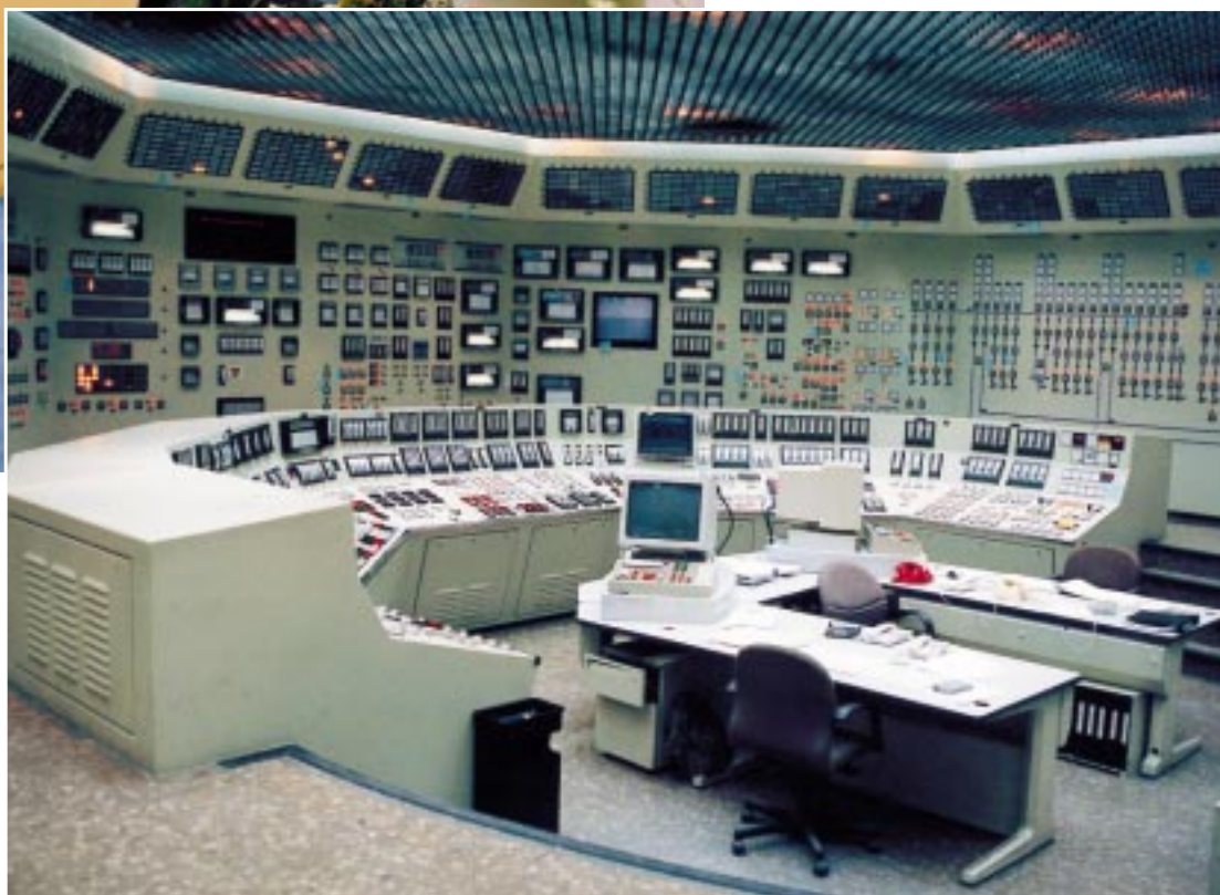
Vista general de las salas de control de Ascó y Vandellós II.
