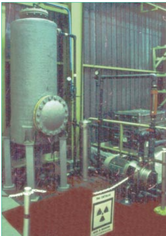
Sistema de depuración de agua
