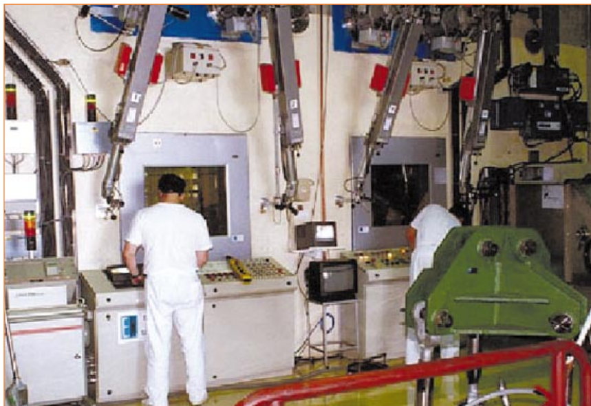
Celda blindada de llegada de residuos en el ATC
