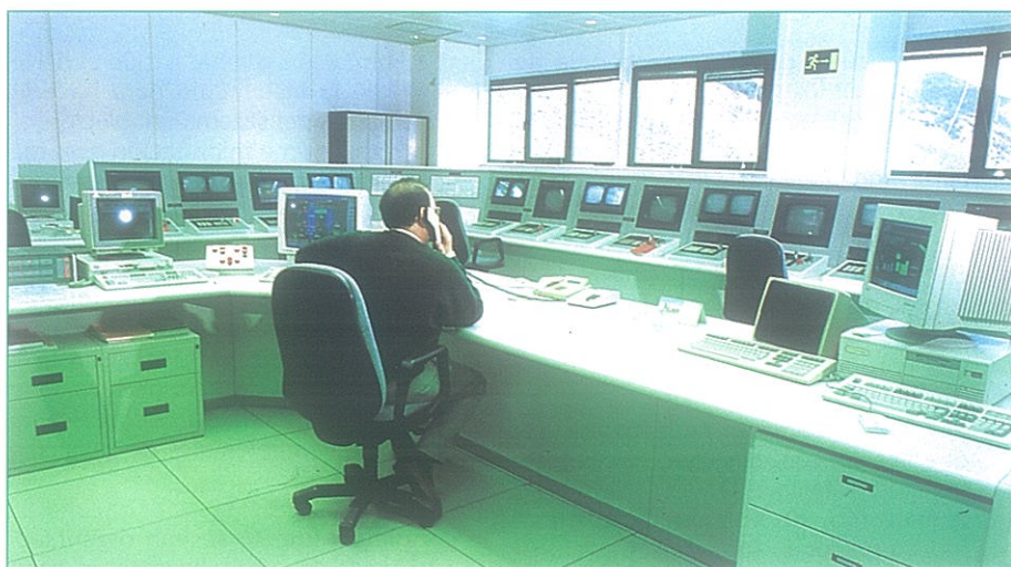
Sala de Control de El Cabil.
