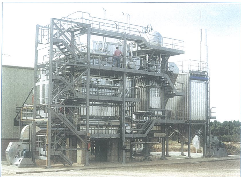
Planta de demostración de lecho fluidizado burbujeante de 3,6 KW. 3.6 KW bubbling fluidized bed demo plant.
