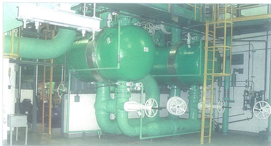
Cambiadores del sistema de refrigeración.
