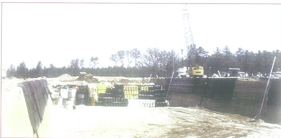
Instalación de almacenamiento de RBA (Hanford, EE.UU.). LLW disposal facility (Hanford, USA).
