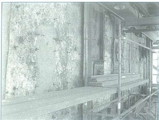
Aislamiento existente bajo casing
