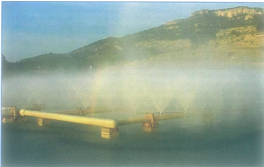
Campos de aspersores del UHS, con nuevas boquillas difusoras/ UHS sprinkler field, with new spray nozzles.
