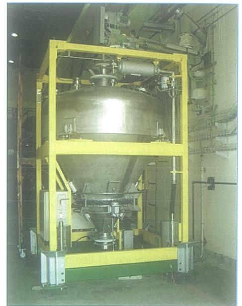
Foto 2. Sistema de Transferencia.
