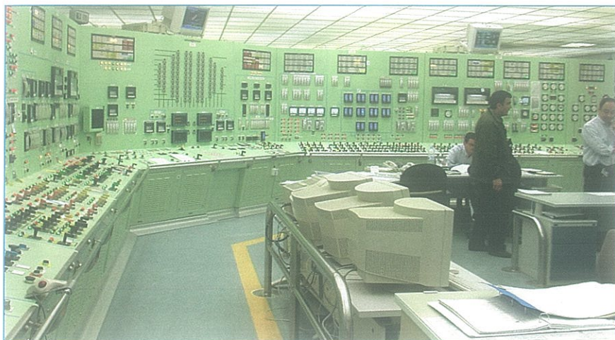
Sala de control.
