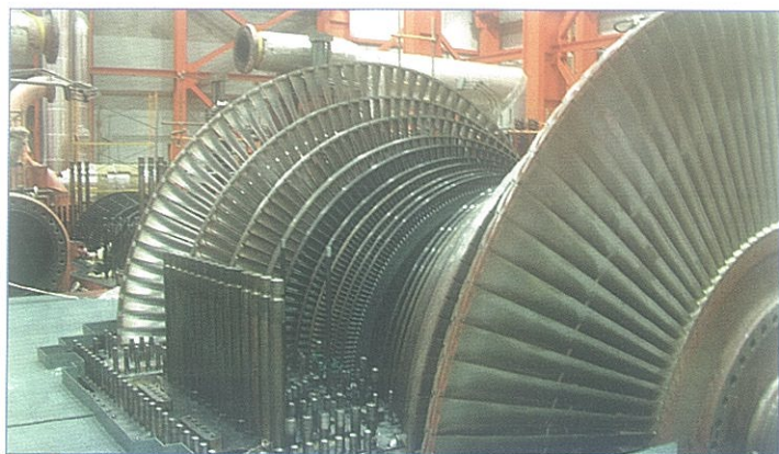
Rotor de baja presión de Vandellós II.
