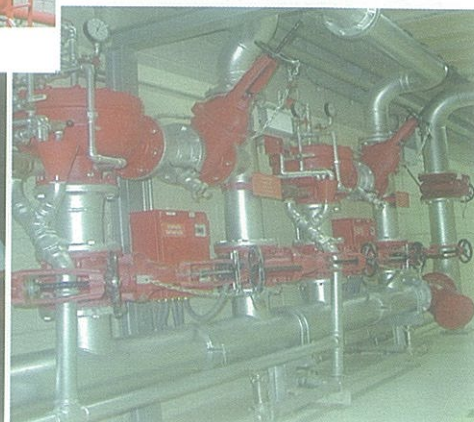
SISTEMA DE EXTINCION
