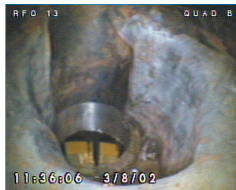
Cavidad en la tapa de la vasija debida a corrosión por ácido bórico.
