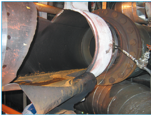
Rotura de tubería del secundario debida a erosión corrosión.
