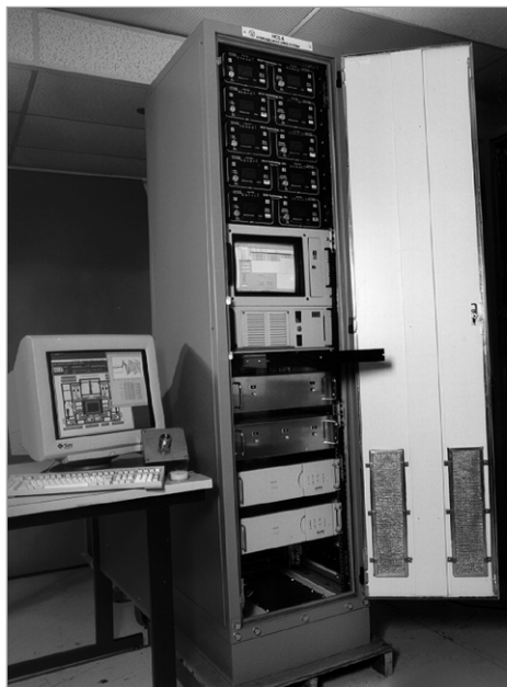
Figura 8. Cabina de Control y Diagnósis y Estación de Trabajo ALLY.
