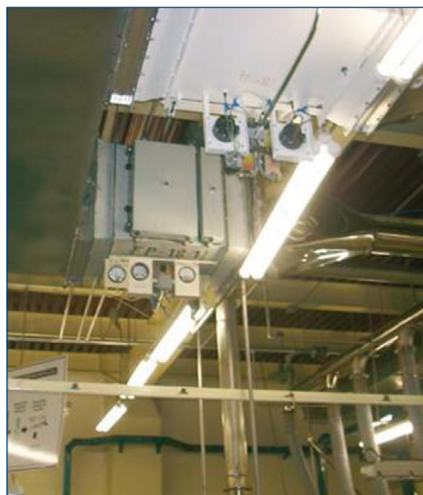
Filtro primario de efluentes radiactivos gaseosos.
