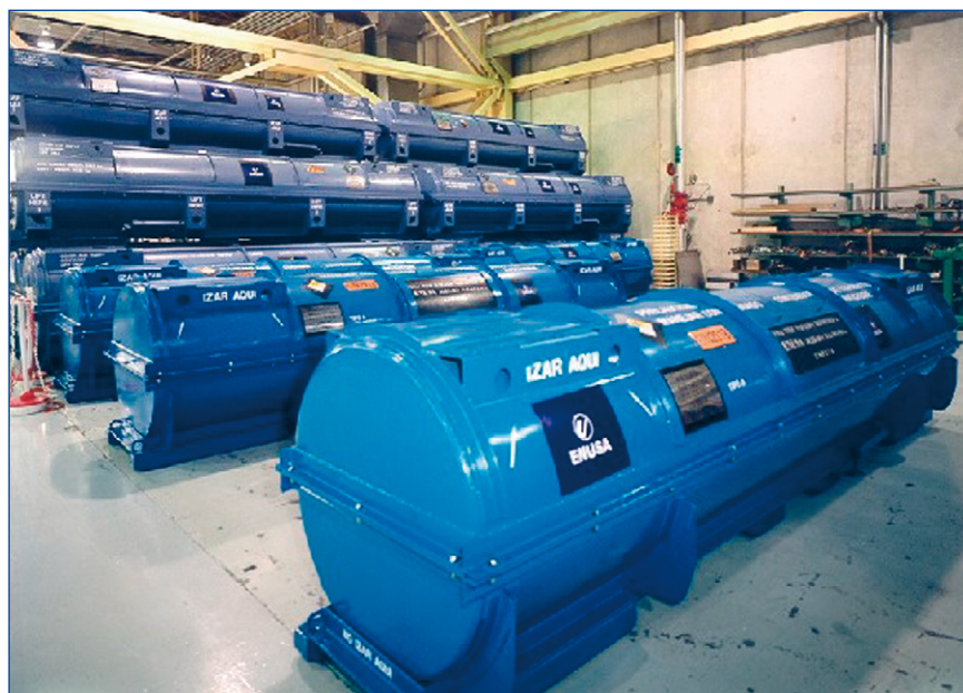
Foto 5. Contenedor combustible PWR.
