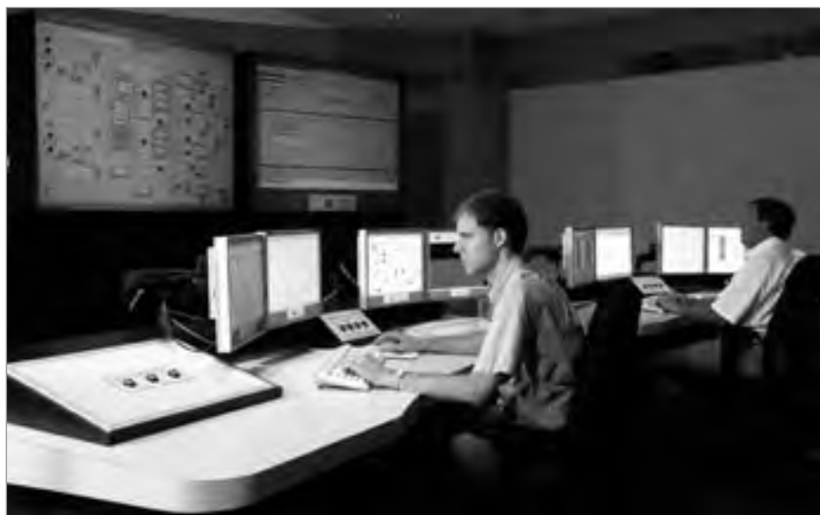
Figura 6. Sala de control avanzada del AP1000.
