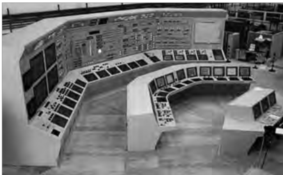
Figura 3. Simulador de la Sala de Control de Lungmen (alcance de Inabensa, RDE, y Tecnomat).
